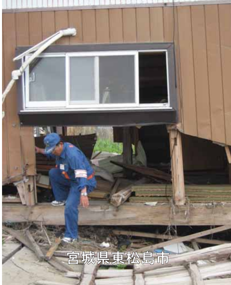
1110_4_018_033490_東松島市_2011.6.18_被災家屋
